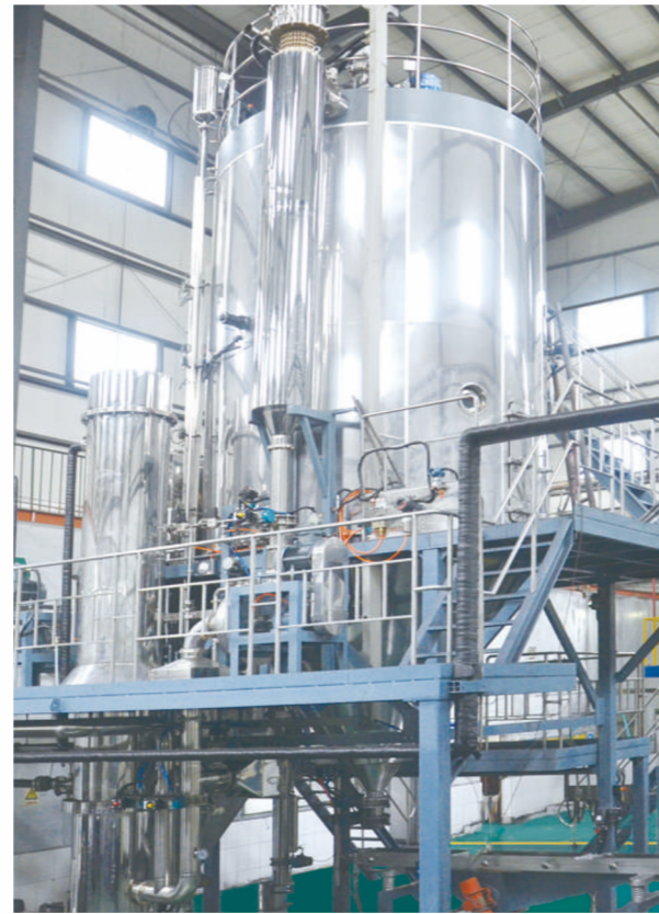
喷雾塔 Spray Tower
